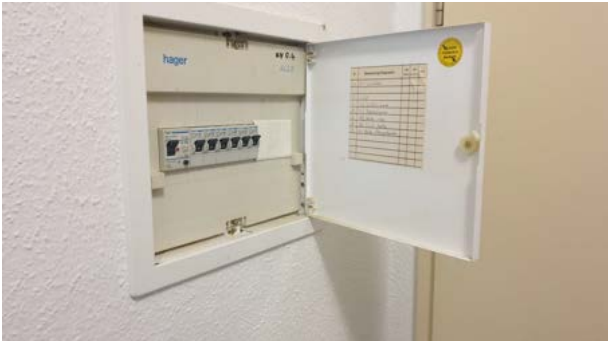
Foto 1 – Beispiel für Bestands-Elektroverteiler für Nachrüstung FI/LS 1TE
