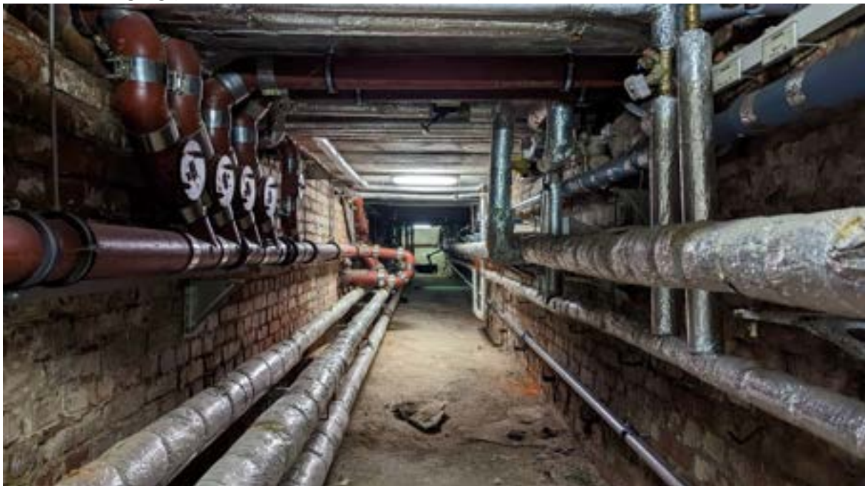
Foto 2 – Kellergang (Erschwernis für LV-Pos. 2.3 und 4.7)
